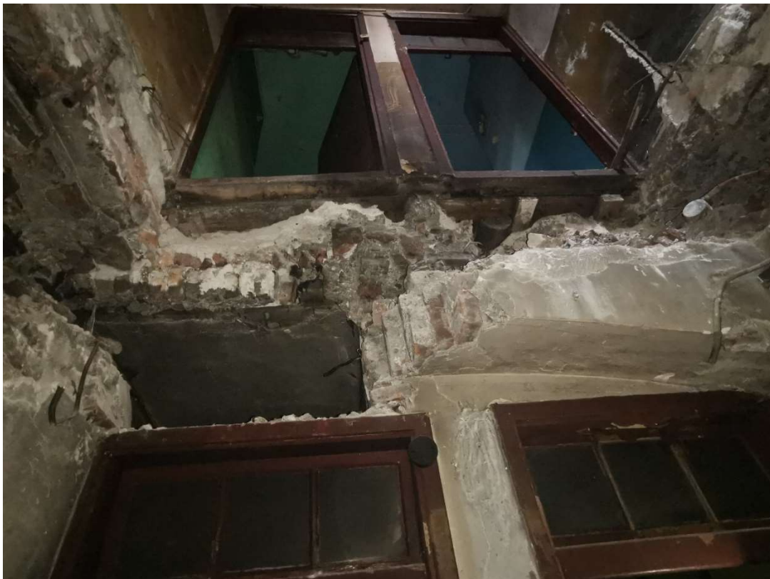
Fot. 24. Zarwany spocznik na klatce schodowej pomiędzy parterem a pierwszym piętrzem
