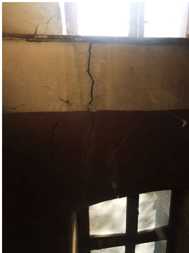
Fot. 28. Pęknięcie ściany klatki schodowej
