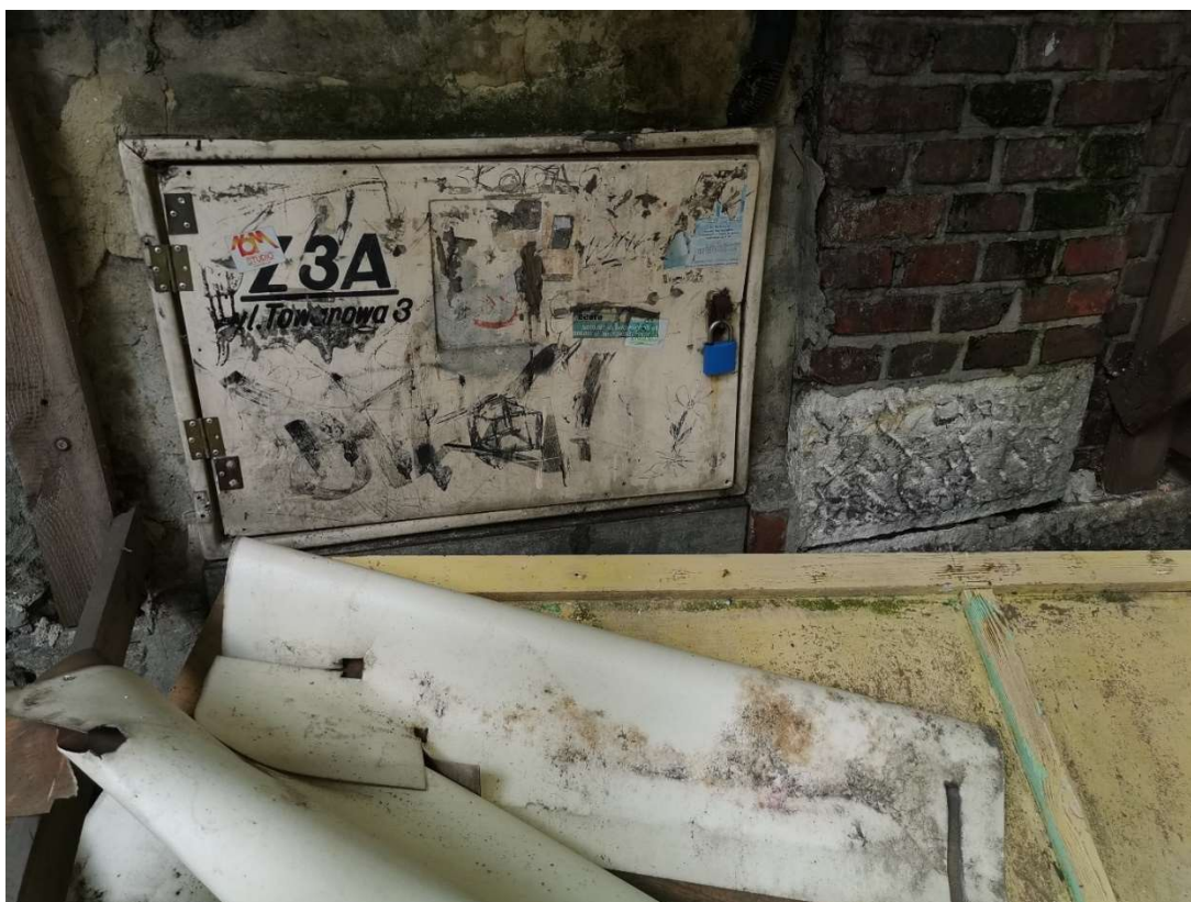
Fot. 17. Skrzynka ze złączem kablowym Z3A na elewacji od strony ul. Towarowej
