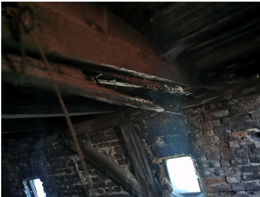
Fot. 37. Uszkodzona krokiew dachowa
