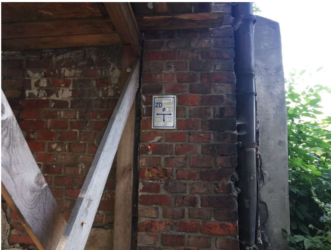
Fot. 18. Tabliczka znamionowa sieci zewnętrznej na elewacji od strony ul. Towarowej
