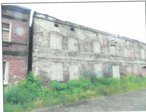
Fot. 03. Budynek mieszkalny – widok styku budynków brak przewiązania muru nr 1
