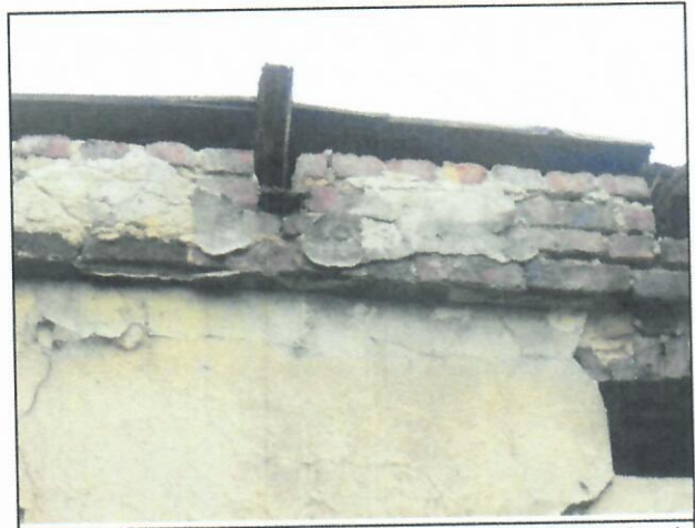
Fot. 02. Budynek mieszkalny – widoczne uszkodzenie konstrukcji dachu.
