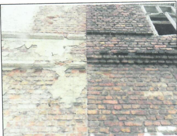
Fot. 04. Budynek mieszkalny – widok styku budynków brak przewiązania muru nr 2
